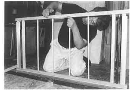
組み立て それぞれの部材を組み立てる。この後、すだれ貼りをする。
